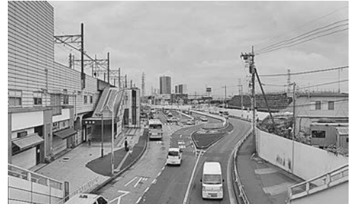
相模原市橋本駅とリニア神奈川県駅工事現場 右手土嚢の箇所が「さがみはらリニアひろば」
